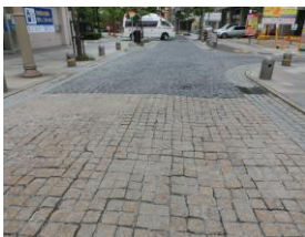
うすい百貨店と寿泉堂総合病院の前面道路の舗装は波打っていて、つまずきそうになった。
