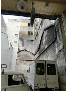
隣接する貸ビルからの出火で中屋ビルと同様に被害を受けた丸源興産のビル。 撮影：2013年4月21日
